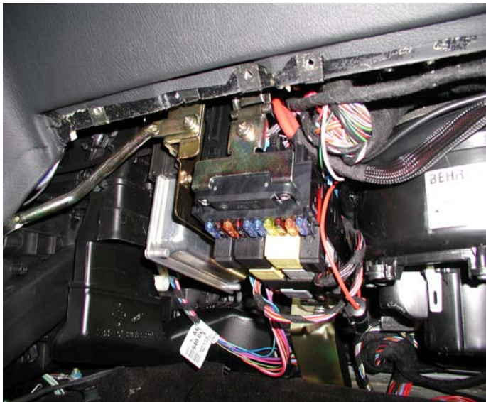
Bild 2. Sicherungskasten mit SAM Fig 2: fuse box with SAM
